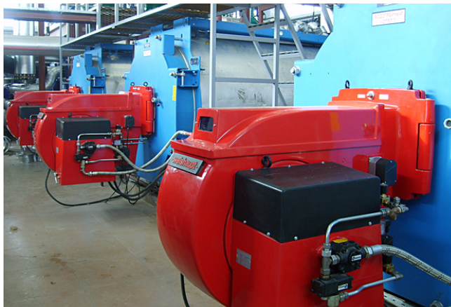
Котельная Дворца спорта в Астане
