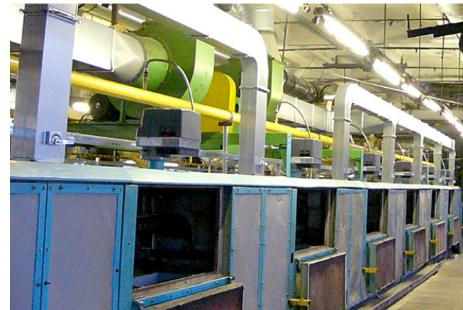
Горелки Weishaupt на сушильно-ширильных машинах ЭЛИТЕКС
